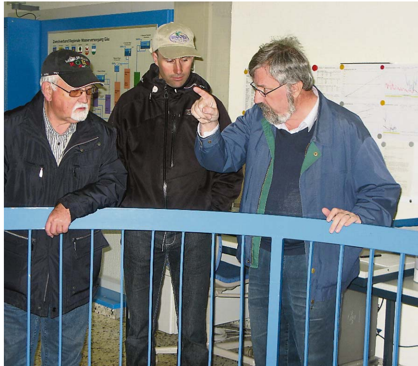
Linus von Arx, der Präsident der Betriebskommission des Gäuer Zweckverbands, erklärt im Pumpwerk Neufeld das Funktionieren der Wasserversorgung.
